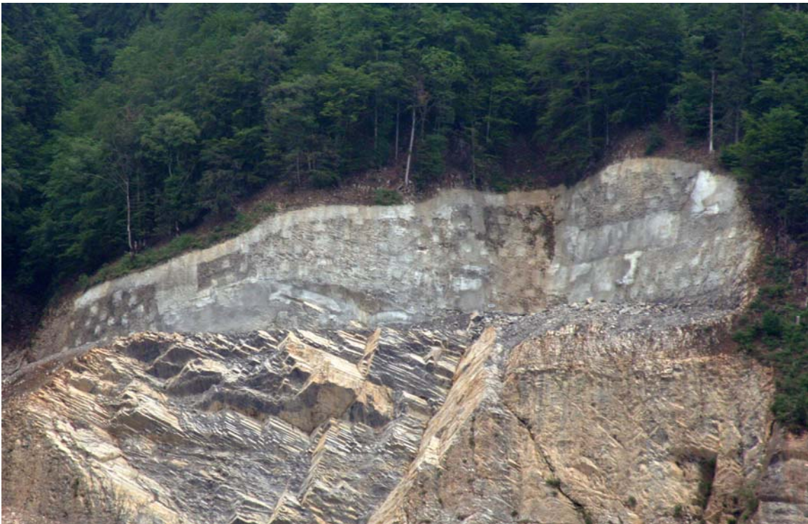
Figure 3: dernière terrasse, paroi avec clouages, effondrement, et dièdre instable.
